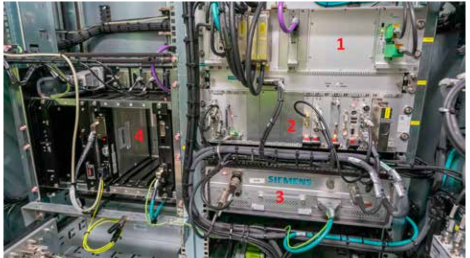
Veturilaitteiden elektroniikka on sijoitettu konehuoneen laitekaappiin. Kuvassa oikealla on kolme harmaata ETCS-yksikköä päällekkäin. Ylimpänä on ETCS-laitteen EVC-yksikkö (1), keskellä DCC-yksikkö (2) ja alimpana antennin sovittimena toimiva BTM-yksikkö (3). Vasemmalla on mustia yksiköitä sisältävä STM-laitteen räkki (4). Kuva 14.1.2021 veturi 3315, Ari Julku.
