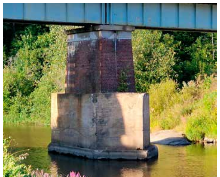
Kuva 3. Välituen tiilimuurauksessa on ollut vaurioita.
