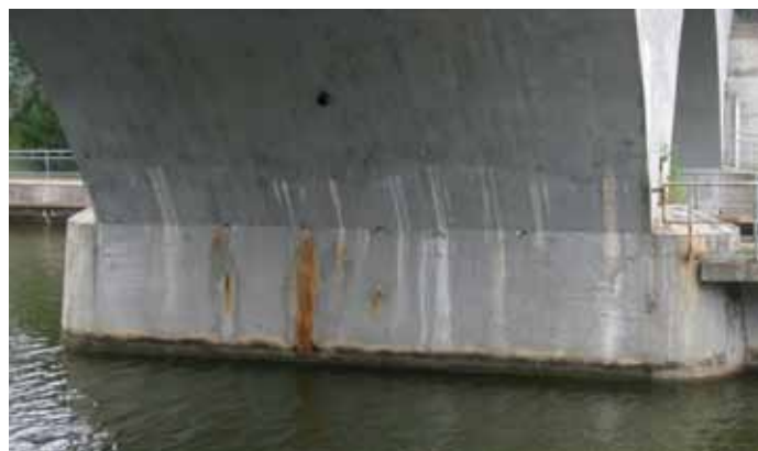
Betonipinnoilla on vesivuotoja korjausyrityksistä huolimatta.
