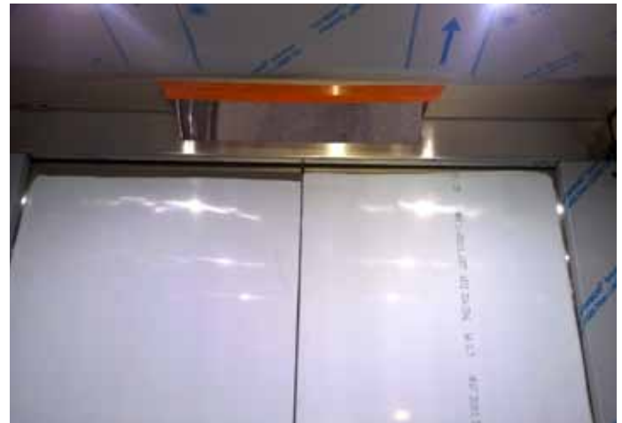
Hissin katossa oven edessä on peili pyörätuolilla peruuttamista varten. Kuvanottohetkellä hissien seinissä ja ovissa oli vielä suo- jamuovit paikoillaan.
