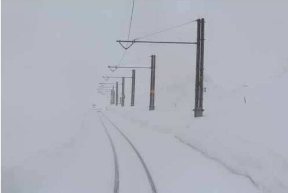
Puisia kaksoisajojohtopylväitä MGB:llä. Ne on suunniteltu kestä- mään vaativimmatkin olosuhteet, kuten tässä lopputalvena 2018 junan ajassa lumimyrskyn läpi. Kuva Markku Nummelin
