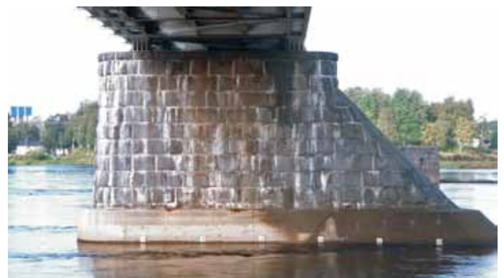
Kuva 3. Sillan kiviset välituet, joita on vahvistettu vuonna 2009.
