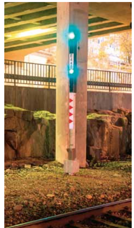
Yhdistelmäopastin Pasilan laiturin 1 eteläpäässä. Kuva Simo Toikkanen
