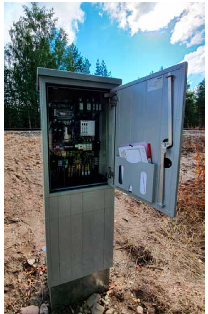
Vamos-laitoksen keskusyksikkö on koottu kompaktiin laitekaappiin, joka pysyy lämpimänä pakkasillakin. Kuva: Vesa Ruuhomäki
