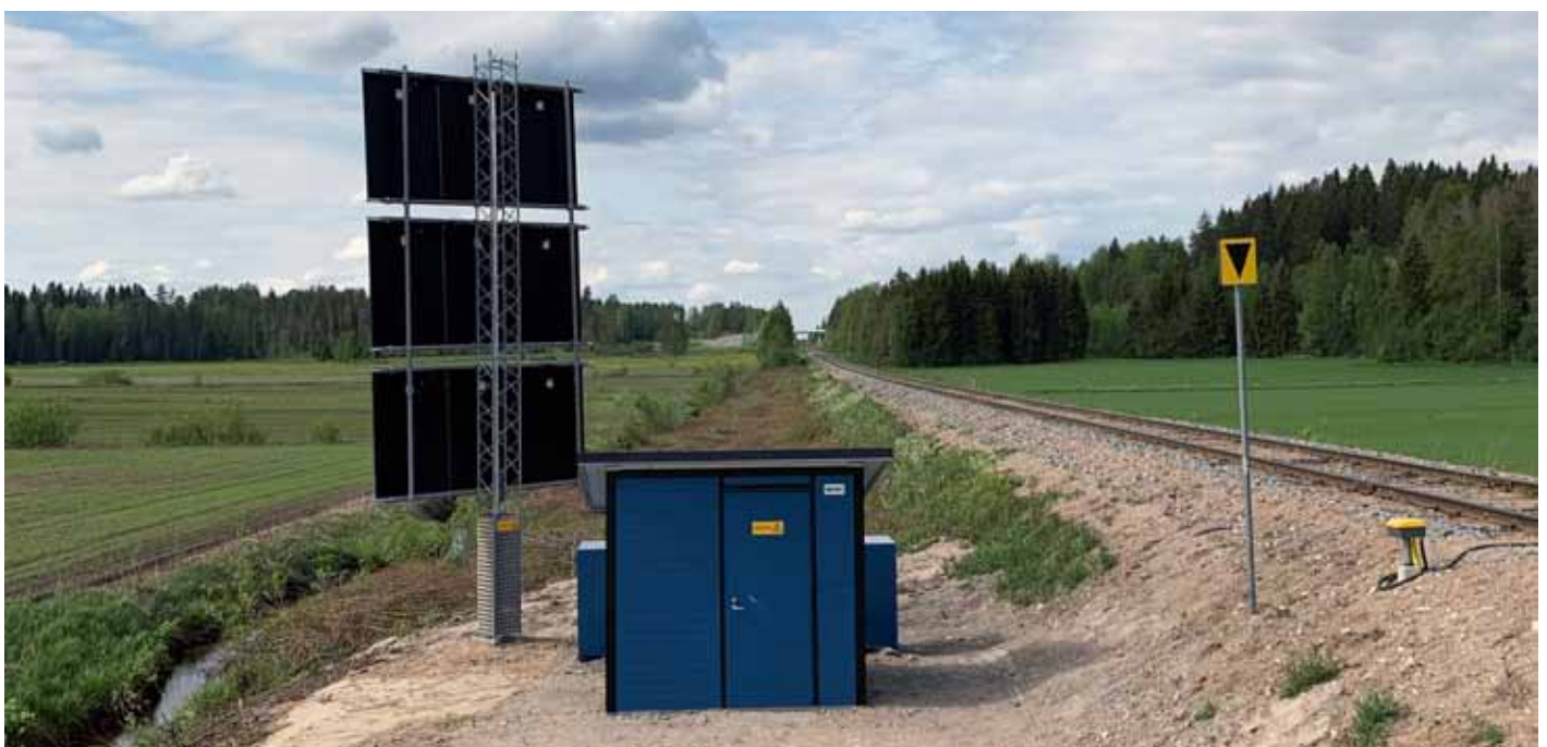
Korvenrannan laitos toimii aurinkoenergialla. Kokeilussa on myös uusi laitetila, jonka katto aukeaa kokonaan ja mahdollistaa painavien akkupakettien vaihdon autonosturilla. Kuva: Miro Pakarinen
