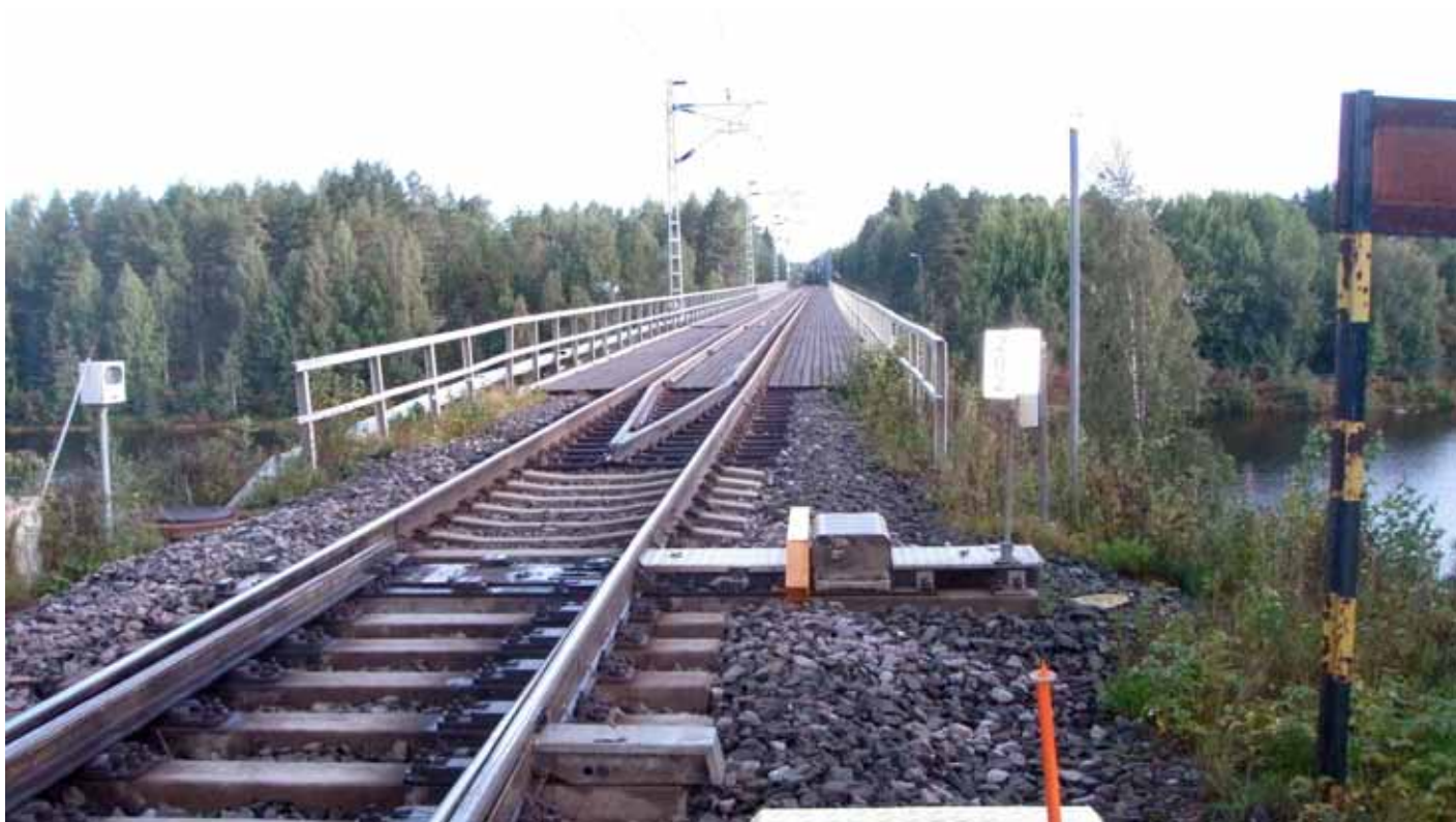
Kuva 9. Sillan eteläpäässä on ratapihan vaihde, jonka sijainti sillan maatuella aiheuttaa raiteenmittauksissa ongelmia.
