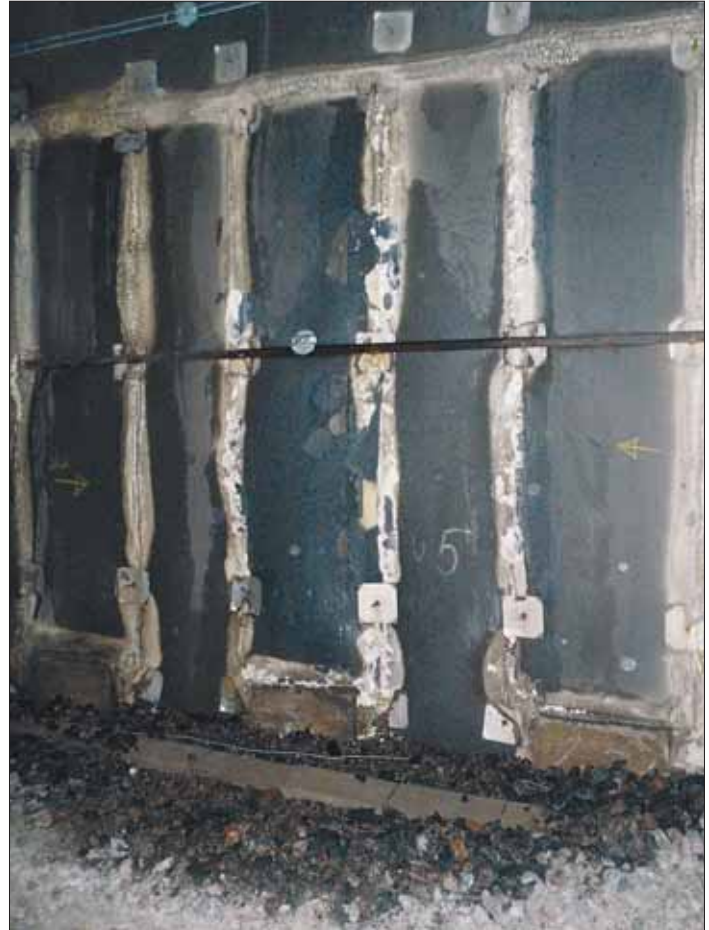
Vaurioitunut eristerakenne, jonka läpi tapahtuu jatkuvaa vesivuotoa.
