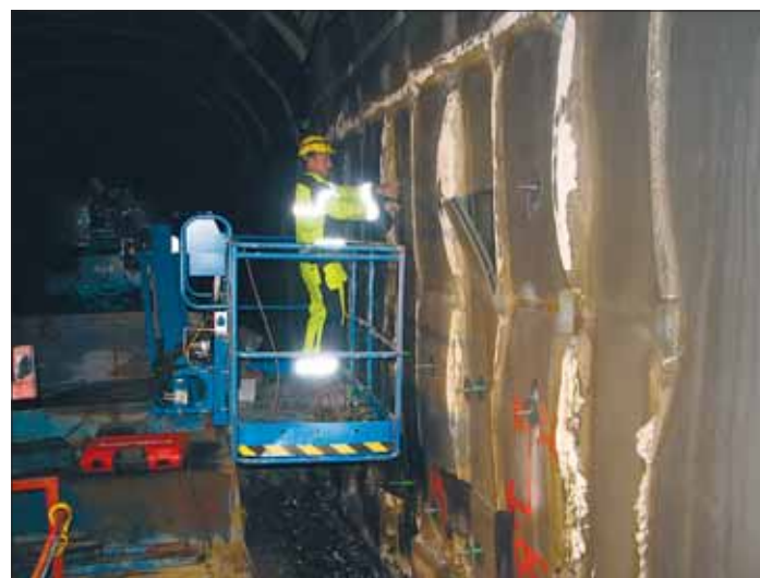
Kallioankkureiden ja aluslevyjen asennus käynnissä. Kuvan keskellä polyeteenilevyyn tehty kulkuaukko, jonka kautta päästiin eristeen taustalle poraamaan kiinnitysankkureiden reikiä.
