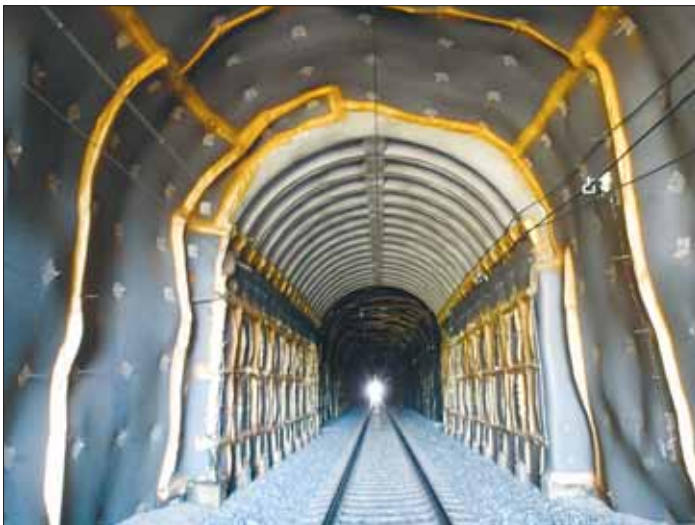
Koteloeristerakenne Tottolan tunnelissa.
