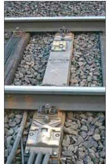
Kuva 1. Yhdistetty laakereiden ja jarrujen lämpötilojen mittausta, Saksa.
