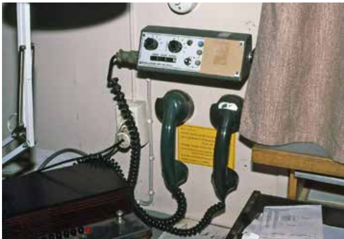
Linja- ja ratapiharadiojärjestelmän kehittyminen junasuorituksen, veturihenkilökunnan ja vaihde miesten välillä helpotti yhteydenpitoa junaturvallisuusasioissa. Kuvassa Lohjan aseman linja- ja ratapiharadiolaitteistoa 8.9.2007. Kuva: Jukka Tölkö
