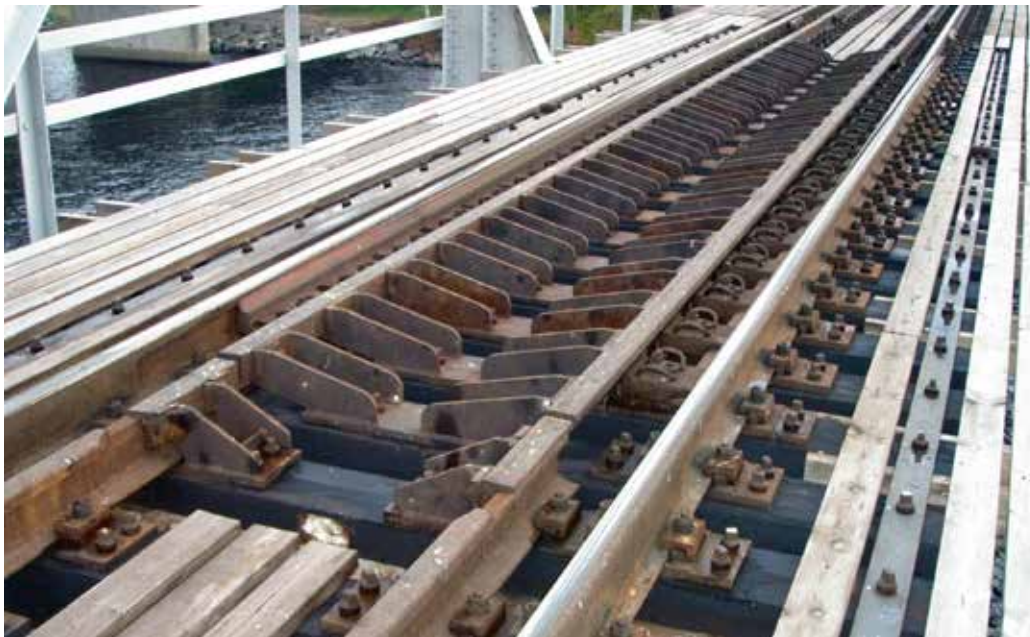
Kuva 3. Kiskonliikuntalaite sillan välituella.
