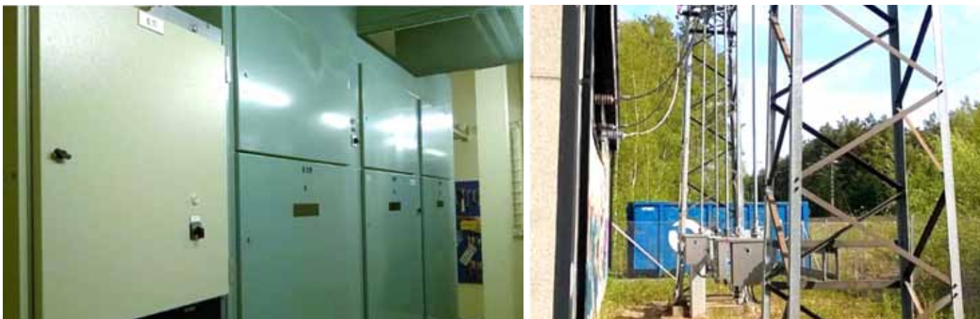
Kuvat 3 ja 4. Mesilä SA, uusi 25kV etelän suunnan katkaisijalähtö ja ratajohtoerotinportaali.
