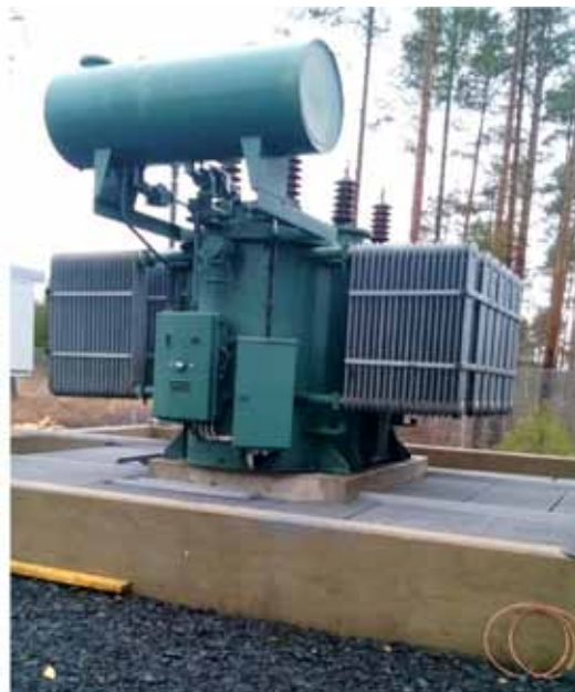
Kuvat 8 ja 9. Ylivieskan ulkokenttä ja päämuuntaja asennettuna.
