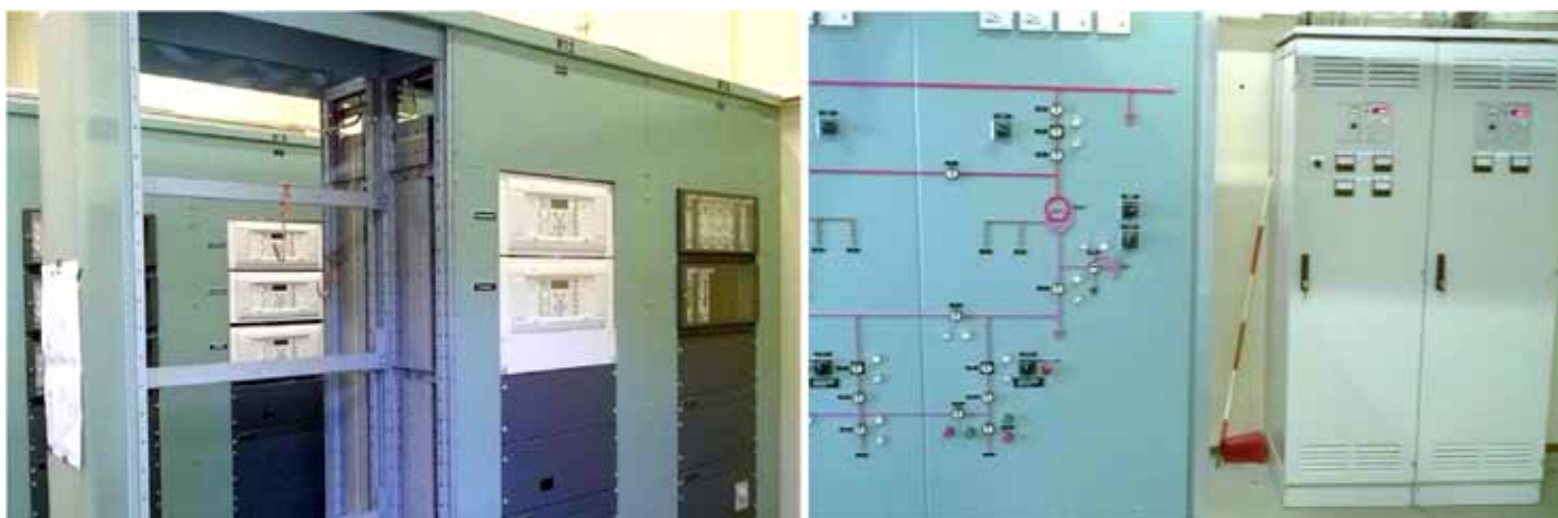
Kuvat 1 ja 2. Mesilä SA, saneerattua suojareleistöä ja uusi tasasähköjärjestelmä (kaappi kuvan oikeassa reunassa).
