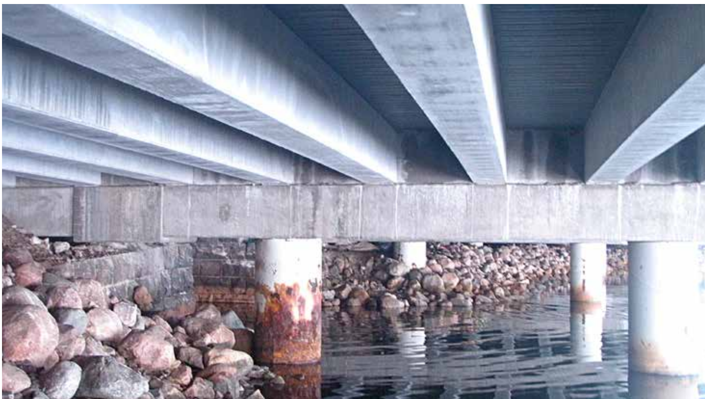
Kuva 5. Läntinen silta on muista sillan osista poiketen moniaukkoinen, paalut ovat ruosteessa vesirajassa.
