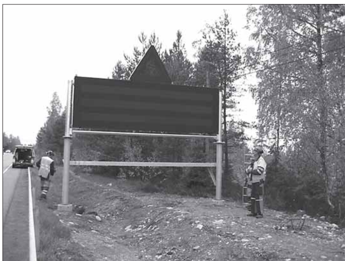
Liikennetelematiikka on informaatio- ja valvontatekniikkaa tieverkolla. Maatieliikenteen ohjaamiseen käytetään muuttuvia merkkejä, yleisempiä ovat nopeus-, kaistansulku- ja kelivaroitukset (kuvassa).
