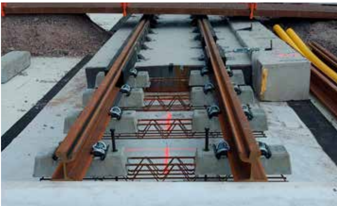
Kuva 1. Puolipölkkyillä toteutetun kiintoraiderakenteen poikkileikkaus ja sekä rakennetta asennettuna Helsingin Kalasatamassa [Kuva Samu Lappalainen]
