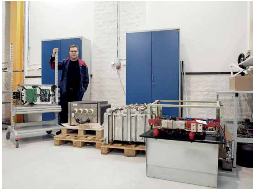
Lasse Laatta ja uuden sukupolven kaluston pääkäyttäjien tehomoduleja. Vasemmalta alkaen telineessä Sm6, Sm3, Sr2 ja Sm4.
