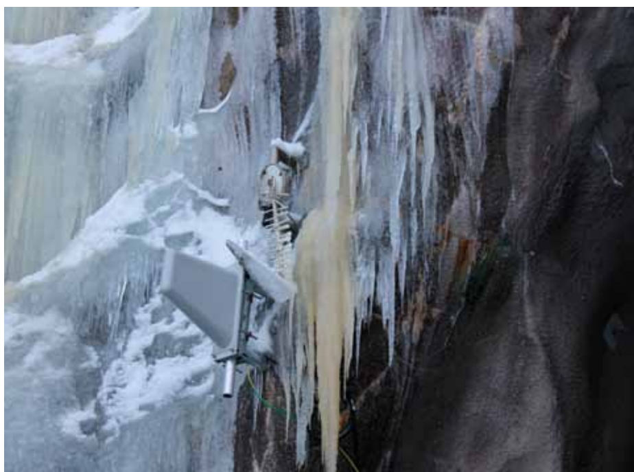
Kuva 2 Mahdollinen häiriö, syynä jäätösuojauksen puuttuminen ja kaapelin asennusvirhe. Kuva Mikael Lindberg
