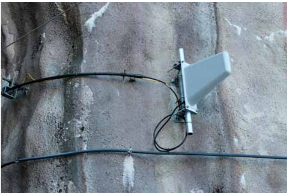
Kuva 3 Antennikaapeleita ei saa kiinnittää toisiinsa eikä kosketuksiin seinän kanssa. Kuva Mikael Lindberg
