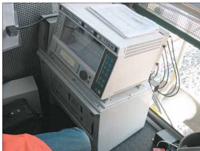
Työjäljen piirturi, jonka alla ALC-ohjaustietokone.
