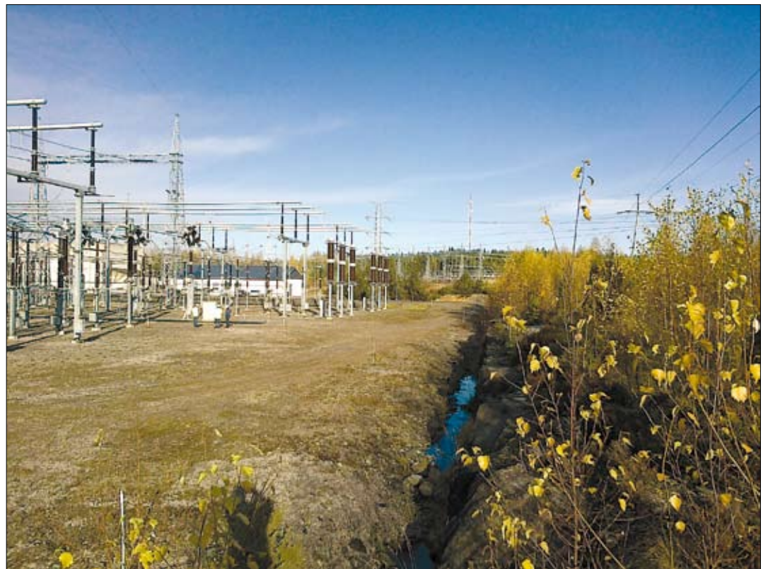
400 kV kytkinlaitos kuvan vasemmassa reunassa, 110 kV kytkinlaitos taustalla telemaston kohdalla. 400 kV laitoksen uuden kokoojakiskon pää tulee olemaan kuvaajasta takavasemmalla. Kaksi lähinnä näkyvää kokoojakiskoa eli nykyiset apukiskot puretaan laajennuksen yhteydessä. (Kuva: Tomi Ovaska, VR Track)
