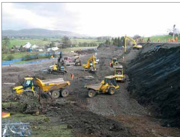
Junan suistuminen Grayriggissä aiheutti suuret vauriot myös rautatiepenkkaan. Kuvassa työmaa viimeistelyvaiheessa (kuva: NR).
