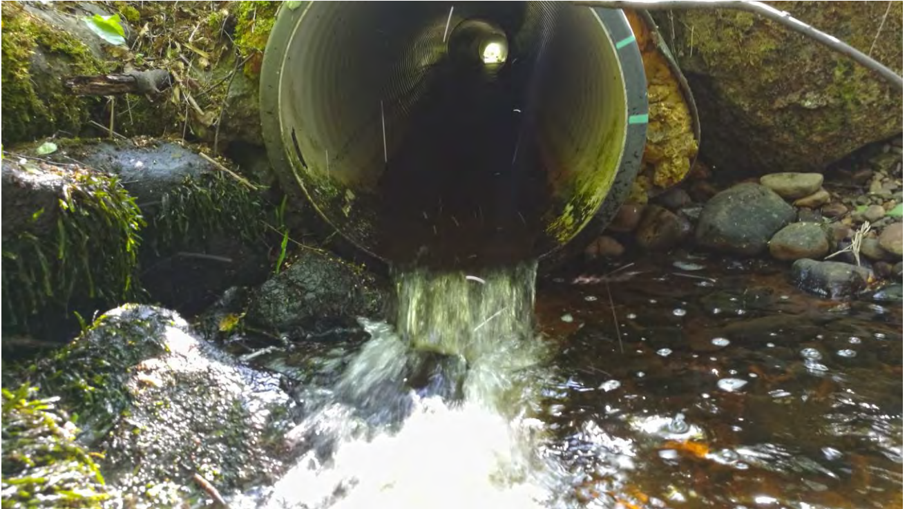
Kuva 41. Ölmosintien rumpu muodostaa vaellusesteen ylävirtaan pyrkiville kaloille.
