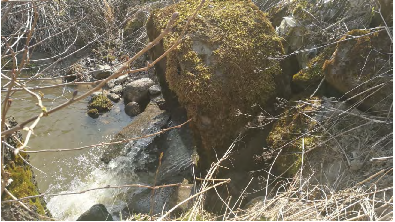
Kuva 7. Hittalanmäen puron ylittävän peltotien sortunut tierumpu muodostaa vaellusesteen kaloille.
