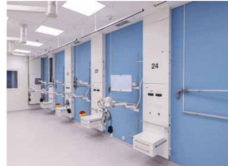
Tulevaisuuden tarpeisiin rakennetun Keski-Suomen uuden Sairaala Novan muuntojoustavuutta tukemaan valittiin lääkinällisille laitteille Florence-potilaspaneelit.
