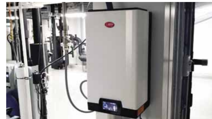
KYS Puijon sairaalan laboratoriotilojen, kuvauslaitetilojen, arkistotilojen ja laitetilojen kosteustasapainosta huolehtii Carel heaterSteam -vastustoimiset ilmankostuttimet.
