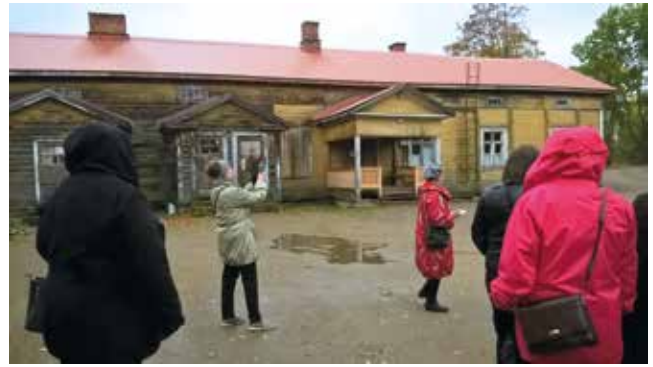
Tilan päärakennus on vaatimaton navettaan nähden ja on valitettavasti päässyt rapistumaan.
