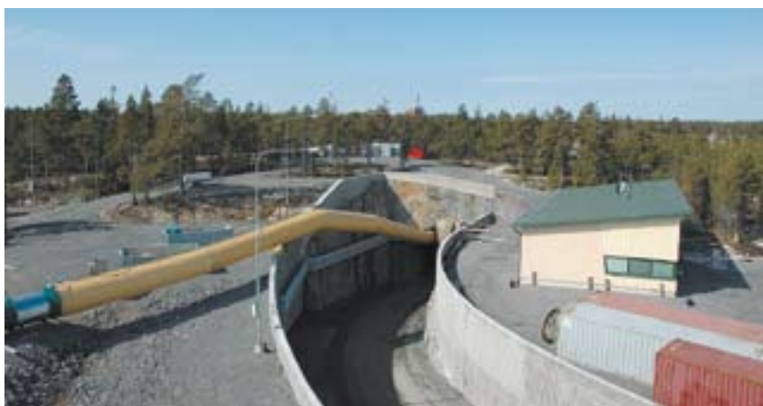
ONKALON työmaa-alue kesällä 2006. Tunnelin suuaukon vieressä sijaitsee vuonna 2005 valmistunut tunnelitekniikkarakennus. Kuva: Timo Seppälä.
