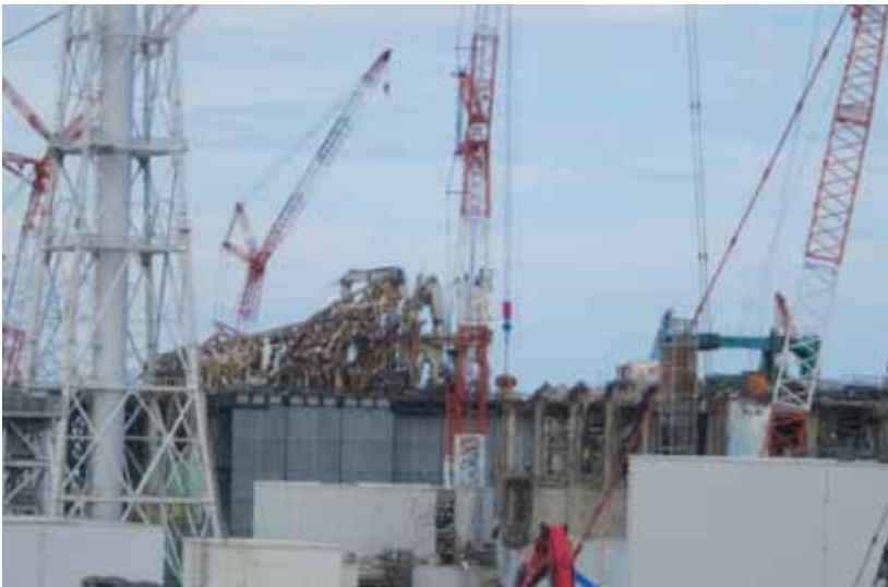
Fukushima Dai-ichin radioaktiivisia nesteitä puhdistetaan Nures-järjestelmällä. Kuvassa näkyy yksiköiden 3 ja 4 purkutöiden etenemistä kuvattuna 5.9.2012. Kuva: Tepco.
