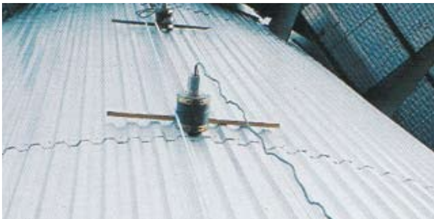
Säteilyilmäisimia keittimen seinämällä.
