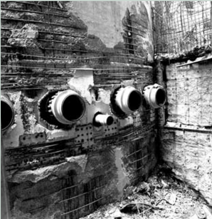
Olkiluoto 1:n reaktorirakennuksessa 8.2.1976 tapahtuneen tulipalon jälkiä. Vaurioitunutta betonia jouduttiin korjaamaan noin hehtarin alueelta.
