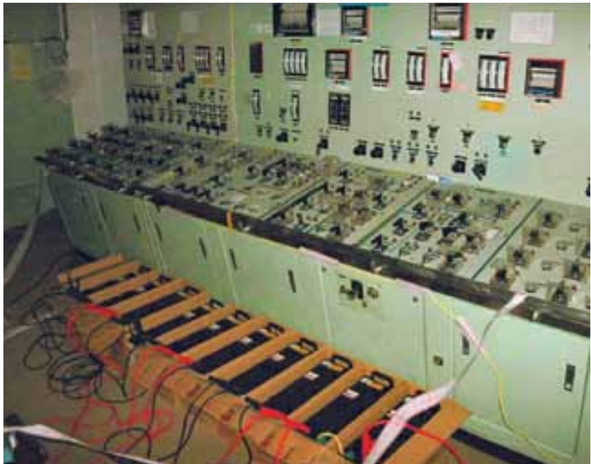
Kuva 6. Laitospaikan akustojen tyhjennyttyä sähköä instrumenteille syötettiin tilapäisjärjestelyin. Kuva: Tepco 20.3.2011
