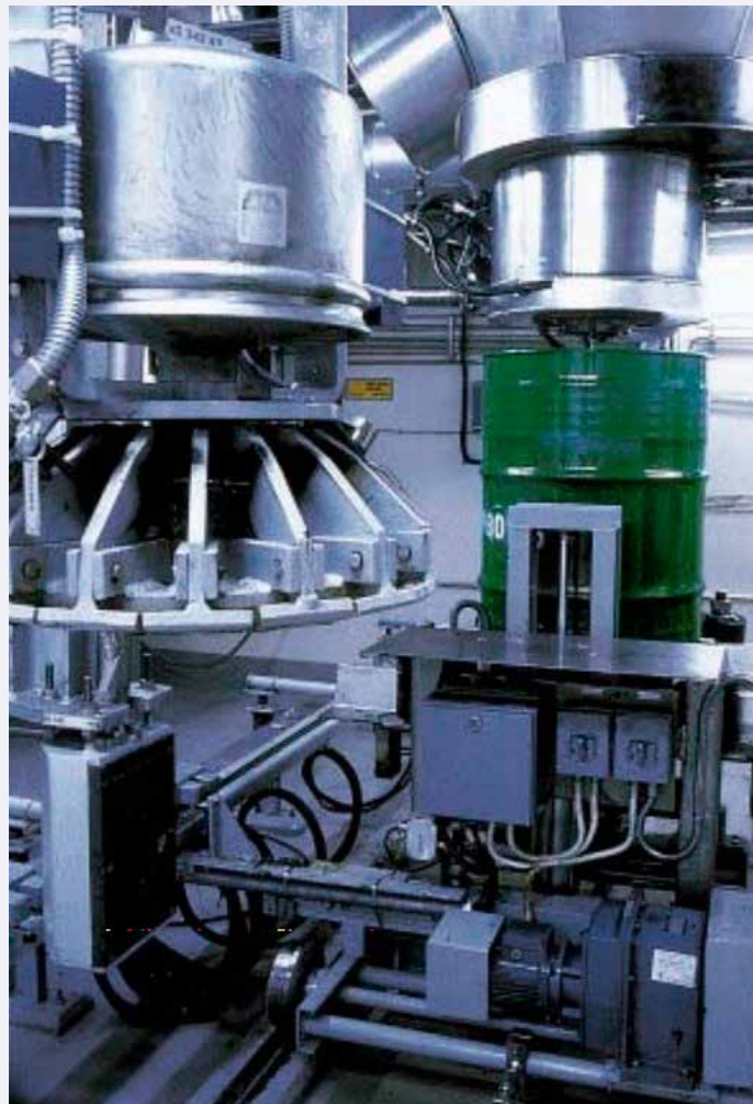
Kuva 4. Bitumikiinteytyslaitteisto (kuva: TVO).
