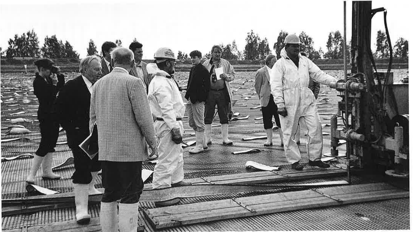
Kone, jolla upotetaan viemäröintiharsoa entisen lietelammen pohjaan saastuneen veden poissaamiseksi. Wismut, Helmsdorf.
