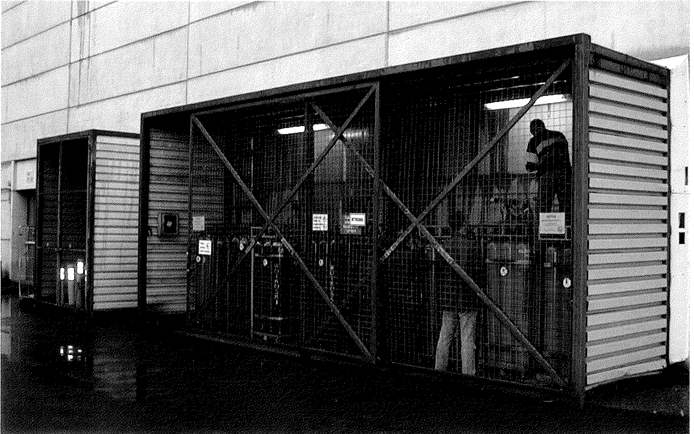
Loviisan kakkoslaitosyksikön vetykeskus kuvattuna lokakuussa 1999. Täällä tapahtui 5.10.1999 vähäinen vetyvuoto, joka johti kriisiviestintätilanteeseen. Syynä oli tapahtumaketju, jossa voimalaitoksella alkaneen vetyvuodon hoitoon otti osaa yli 20 paloautoa ja media.
