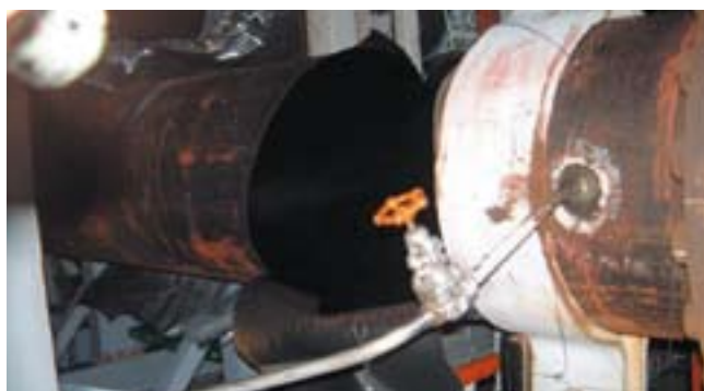
Japanilaisen Mihama 3-painevesilaitoksen elokuussa 2004 murtunut lauhdelinjan putki. Syy neljä työntekijää surmanneeseen onnettomuuteen oli puutteellinen kunnonvalvonta. (Kuva: NITI)
