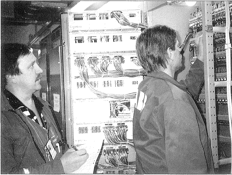
Turbiinaautomaatio uusittiin OL1:llä vuoden 1996 polttoaineenvaihtoseisokissa.
