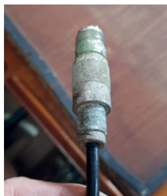
5.33. Hapettunut koaksiaalikaapelin liitin.
