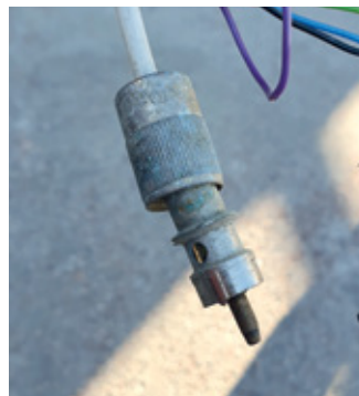
5.32. Hapettunut koaksiaalikaapelin liitin.
