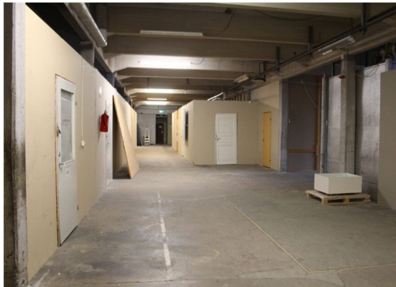
Piippokeskuksen sisätilat kertovat ajastaan, mutta myös mittavasta remonttitarpeesta.
