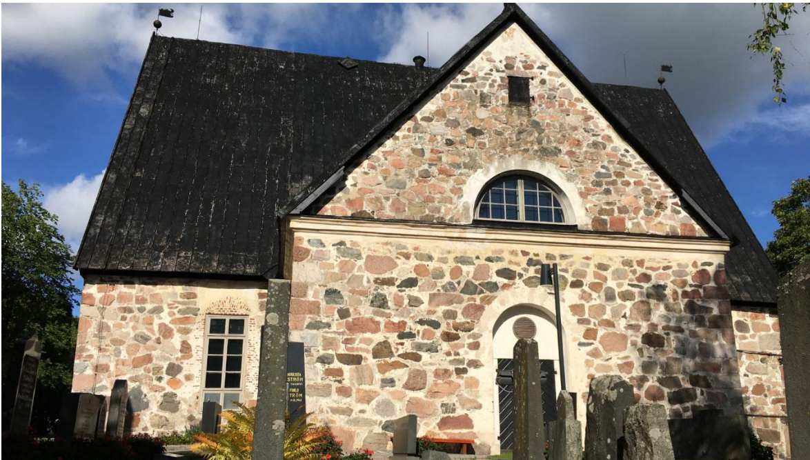
Kuva 2. Espoon tuomiokirkon katon maalaus oli jo vuonna 2020 huonossa kunnossa. Kuva Jarmo Nieminen
